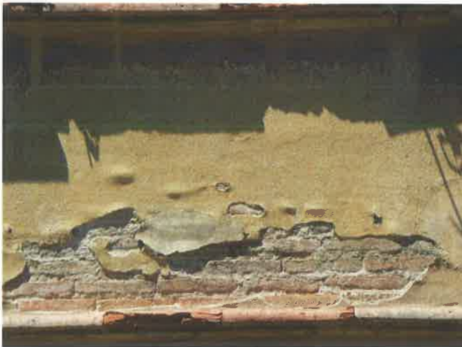
Effets d'un enduit et peinture de type organique sur un matériau minéral (terre, brique, pierre...) : Cloquage et désordres.
