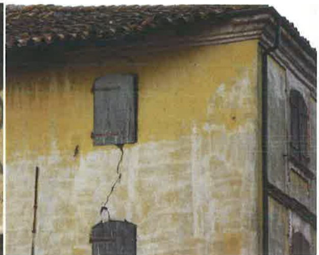
Fissures et désordres du bâti engendrés par les mouvements du sol (retraits et gonflements).
