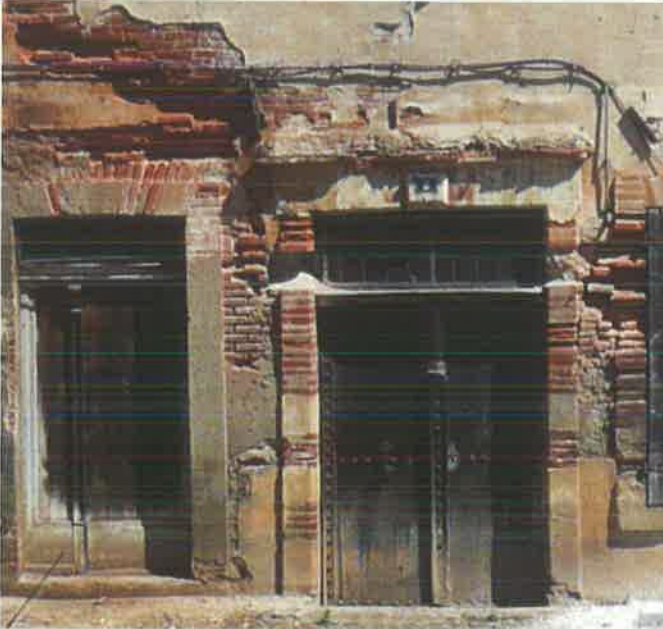
Effets désastreux du point de marnage dans la brique. Les sels contenus dans les remontées capillaires rongent la brique. La pose d'un enduit non perméable et non perspirant (ciment, résines...) ayant pour effet d'emprisonner l'eau dans les maçonneries aggrave la situation.
