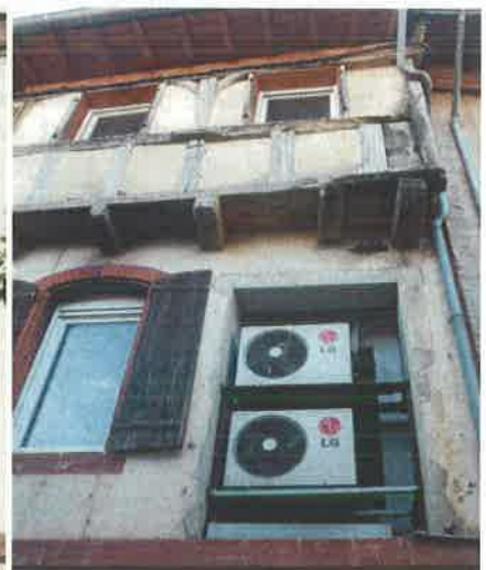
Appareil de climatisation en façade. Fenêtre non adaptée à la forme de l'encadrement, absence de partition de la baie.
