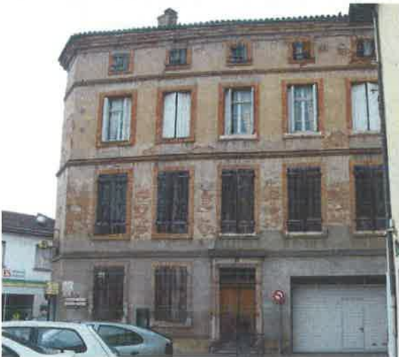
Percement inapproprié du rez-de-chaussée, altération de la symétrie de la façade
