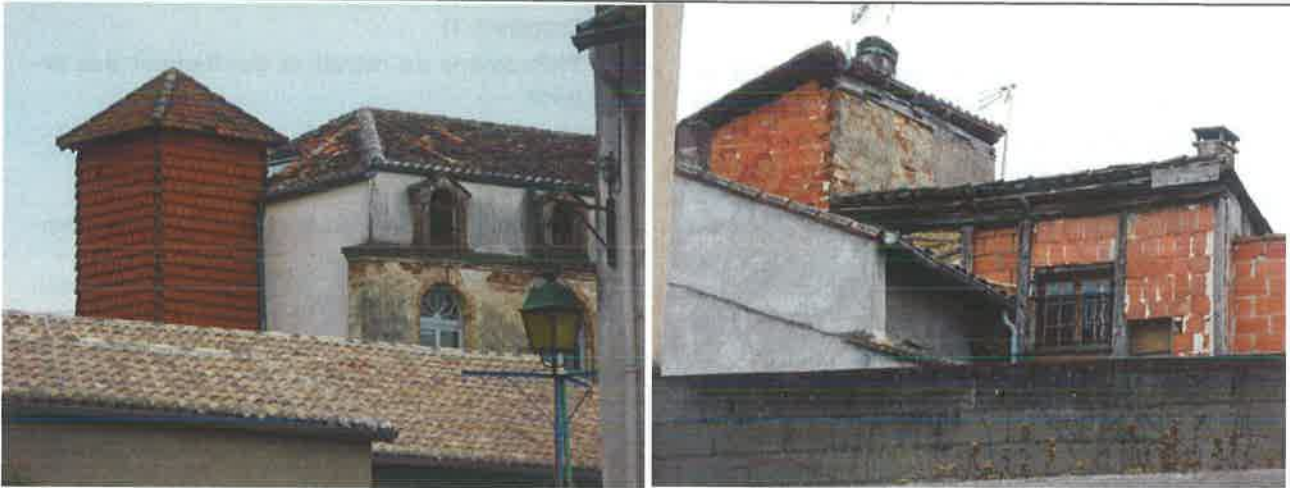
Utilisation de matériaux inadéquats dans les restaurations du bâti ancien. Tour couverte de tuiles mécaniques. Pans de bois hourdés de parpaings sans enduits.
