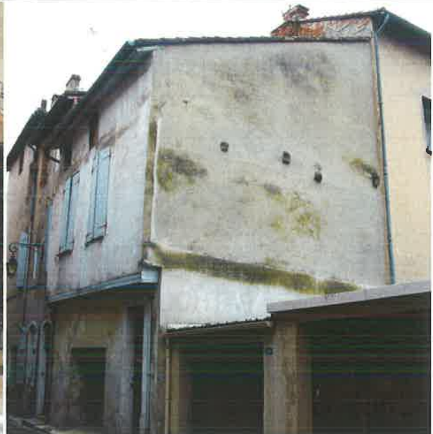
Effets d'un enduit imperméable sur une maçonnerie traditionnelle. Les traces d'humidité provoquées par les remontées capillaires sont visibles sur toute la façade. Lorsque l'humidité ne peut s'évacuer au travers d'un enduit perméable, sous l'effet de la pression l'eau peut remonter sur plusieurs étages. Les maçonneries gorgées d'eau sont en péril, l'atmosphère de la maison est humide et inconfortable.
