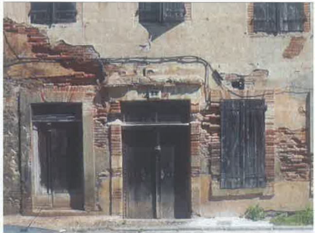
Remontées capillaires et désagrégation des maçonneries anciennes.
