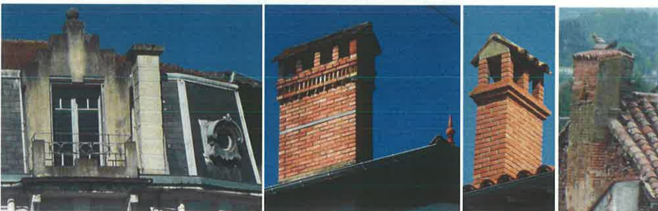
Lucarne passante à redents et oculi de zinc rue Delbreil. Cheminées XX e siècle rue Cayla et rue du Maroc: décors de briques, mitres et épis de faitage en terre cuite.. Cheminée ancienne détail de la souche et de la mitre.
